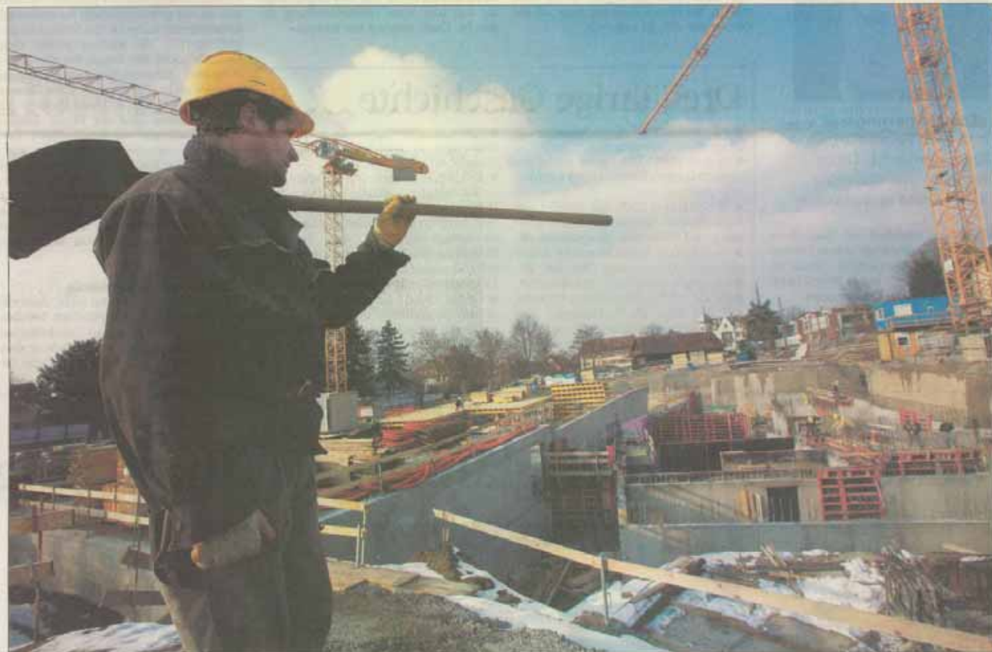
Der Bau der Tiefgarage und des zweiten Untergeschosses des Pflegeheims (im Bild rechts) sind schon weit fortgeschritten.
