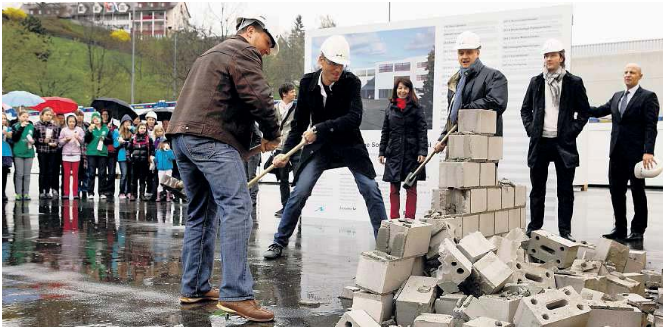
Statt eines Spatenstichs wird eine Mauer eingeschlagen: Gemeinderat Andreas Federer (von links), Architekt Thomas Bucher und Urs Klemm, Leiter des Dienstleistungszentrums Liegenschaften der Gemeinde Thalwil, schwingen den Hammer. Bild: Silvia Luckner
